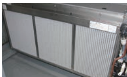
■ 加湿器ろ材交換
