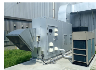
▲ ヒートポンプ空調機
