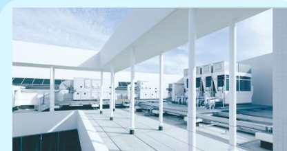
稼働製品ゾーン (屋外) 各フロアに使用されている空調機 及び熱源機器等が設置
